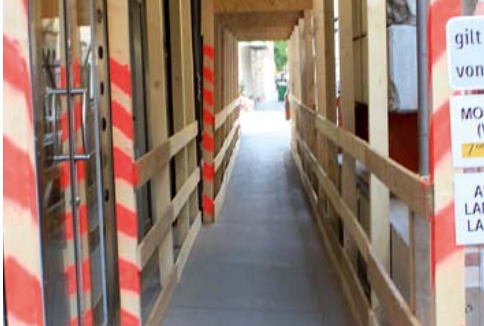
Baustellensicherung mit druckfesten Latten und Tastleisten im Bereich eines Gehsteiges
